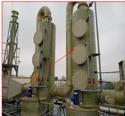
新增加氢间散排废气治理环节（新增） （两级喷淋）
