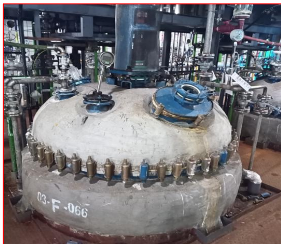
高浓废水蒸馏釜（共用）
