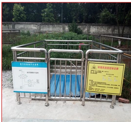
全厂雨、污切换阀（兼做事故废水截断阀）
