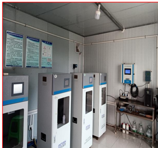
废水在线监测室 (流量、pH、COD、氨氮、TN、TP)
