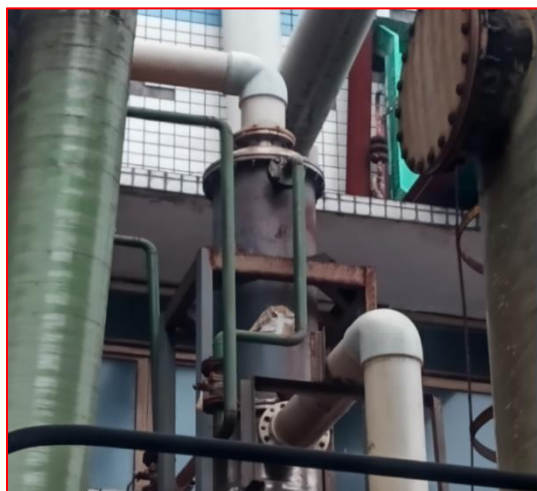
原料药二车间外二级冷凝回收（共用）
