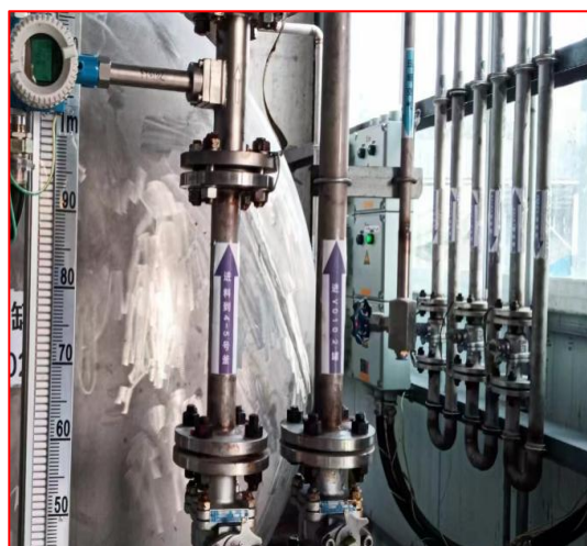
加氢间进料管道（新增）
