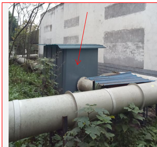
污水处理站厌氧段废气治理设施（共用） （活性炭吸附箱）
