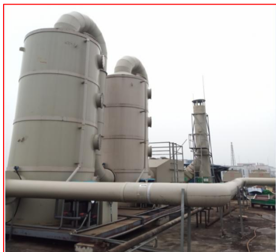
原料药一、二、三车间共用废气治理设施（共用） （碱洗+水洗+干式过滤+颗粒活性炭+在线解析）
