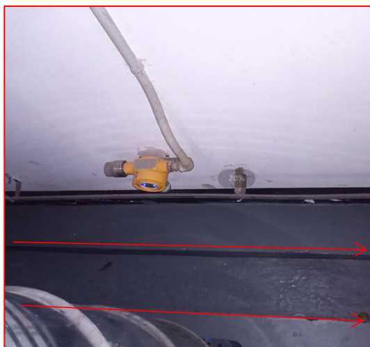
原料药库房可燃气体探测装置及截污沟
