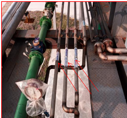
加氢间出料管道（新增）
