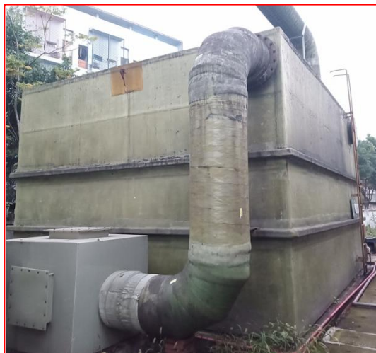
污水处理站厌氧段废气治理设施（共用） （生物滴滤）
