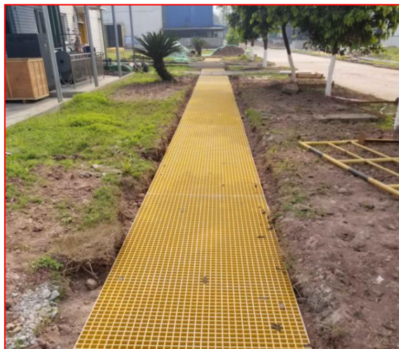
可视化管沟（共用）
