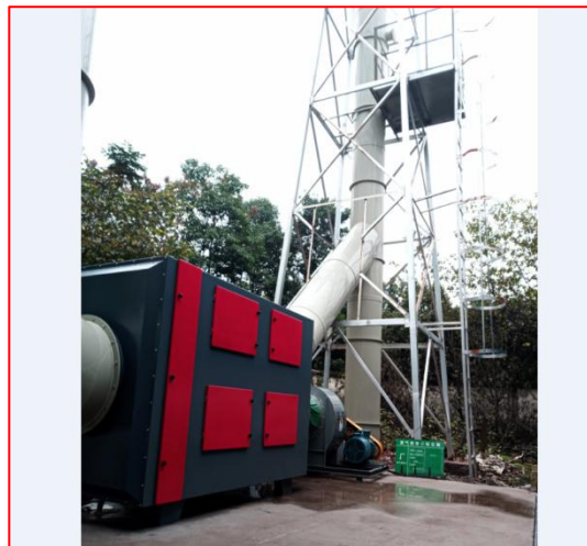
危废暂存间废气治理设施（依托） （活性炭吸附塔+15m 排气筒）
