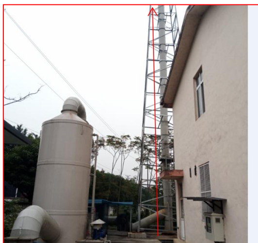
污水处理站好氧段废气排气筒及采样平台 （30m，直径 0.5m）
