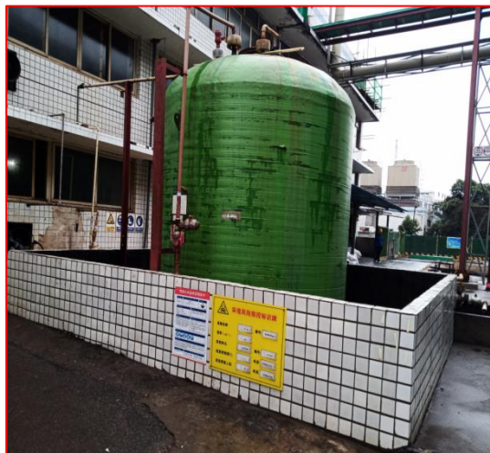
原料药二车间外盐酸储罐围堰 及风险防控标识牌
