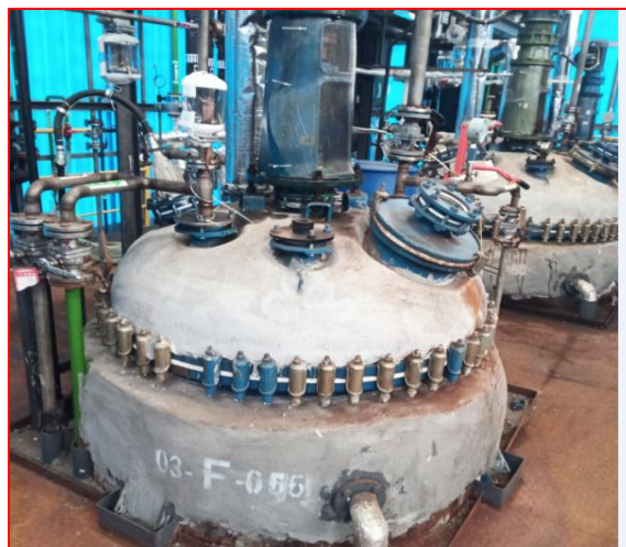
高盐废水蒸馏釜（共用）
