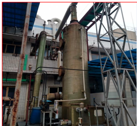
原料药二车间外废气预处理碱洗塔（共用）
