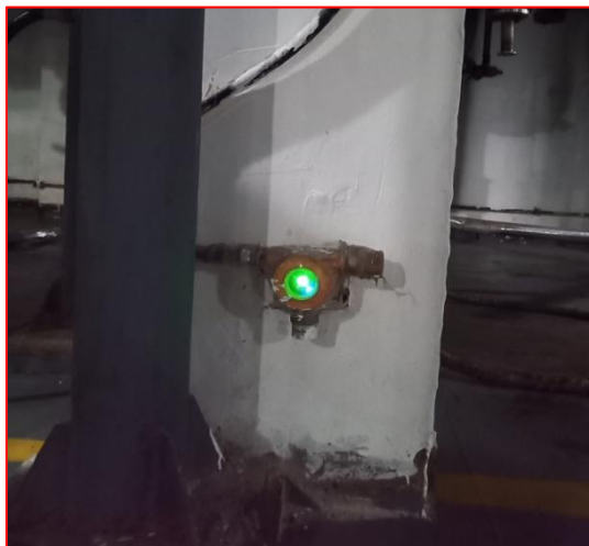
原料药二车间可燃、有毒有害气体探测装置
