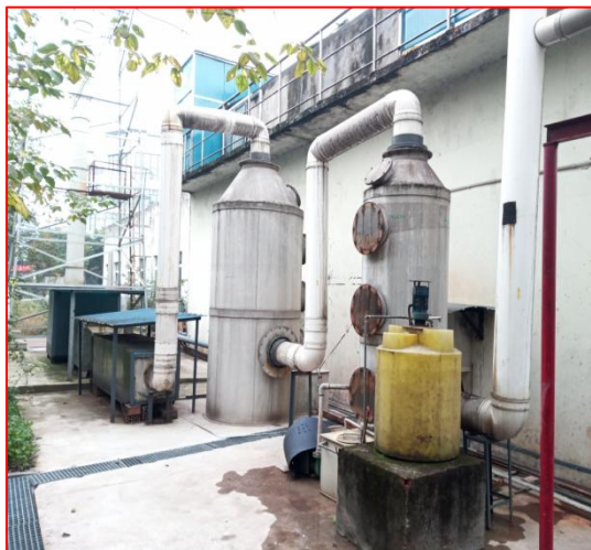
污水处理站前段综合池废气治理设施（共用） （碱洗+除臭喷淋+UV 光解+活性炭吸附）
