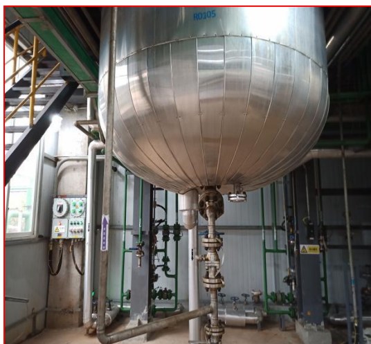
加氢间部分反应釜（新增）
