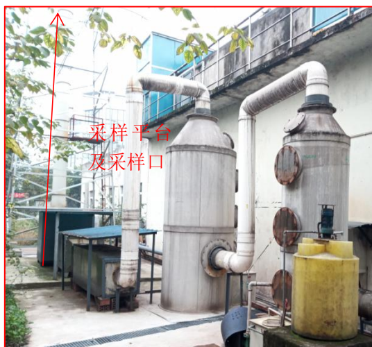
污水处理站综合池及厌氧段废气排气筒 及采样平台（30m，直径 0.5m）
