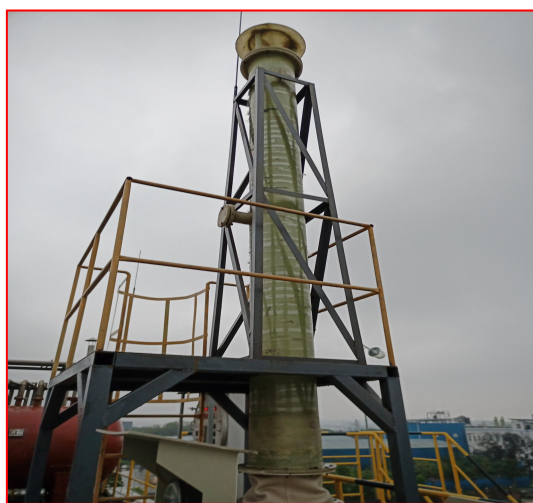
加氢间散排废气排气筒及采样平台 （15m，直径 0.35m）
