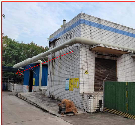
危废暂存间暂存废气收集管道（依托）
