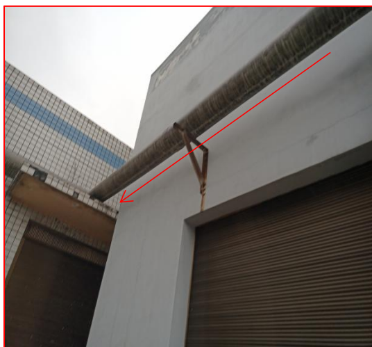
新增危废暂存间暂存废气收集管道（新增）
