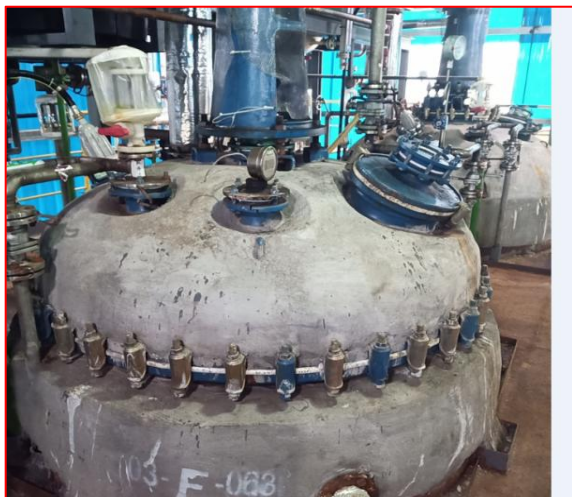
高盐废水中和、絮凝反应釜预处理（共用）
