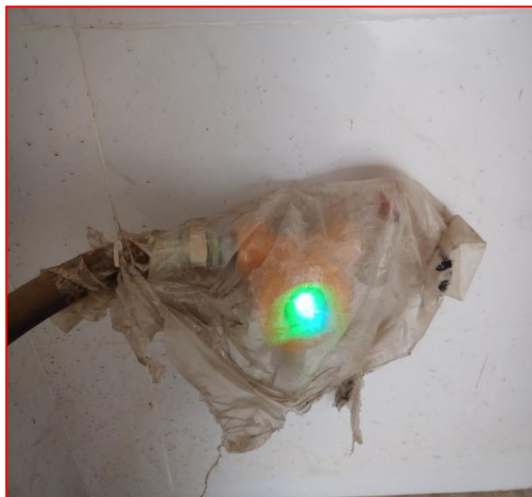
新增危废暂存间可燃、有毒有害气体探测装置
