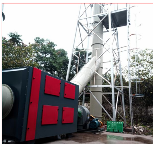
危废暂存间废气排气筒（15m、直径 0.7m） （及采样平台、及废气标识）
