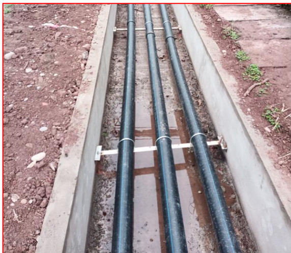
可视化管沟及高浓、高盐、低浓废水管道（共用）
