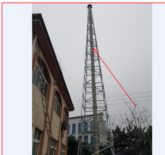
污水处理站好氧段废气排口（共用） （30m、直径 0.5m）
