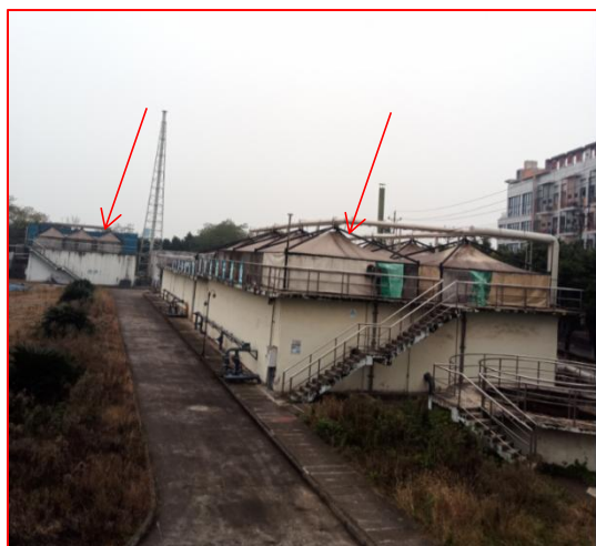
污水处理站废气集气罩（共用）
