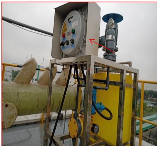
新增加氢间散排废气治理环节（新增） （加药箱）
