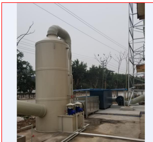
污水处理站好氧段废气治理设施（共用） （碱液喷淋塔+UV 光解+活性炭吸附）
